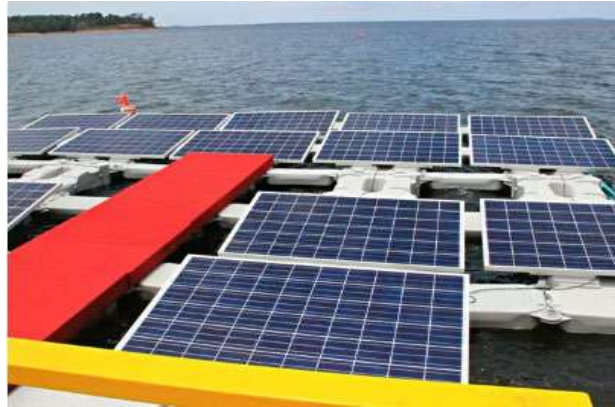
Foto 1: Nova usina solar flutuante no AM deve atender 9,5 mil famílias até 2017
